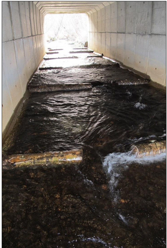
Fig. 20. Kulvert med opestokker som fisketrapp (Foto: Øyvind Haugland).
