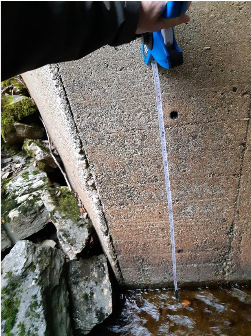
Figur 16: Vannmåling ved brua nedstrøms stasjonen.
