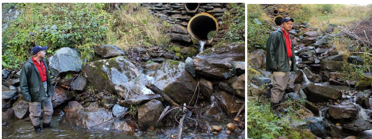
Figur 23. Uheldig steinsetting og stort fall ved utløp av kulvert hindrer fiskepassasje under E14.
