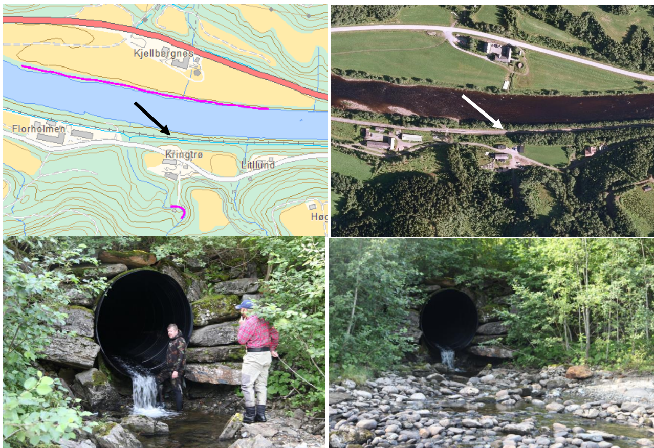
Figur 21. Oversiktskart og flyfoto som viser kulvertens plassering (pil) der jernbanen krysser Holmbekken. Sikringstiltak er markert med røde linjer. Bildene under viser kulverten sett fra hovedelva.
