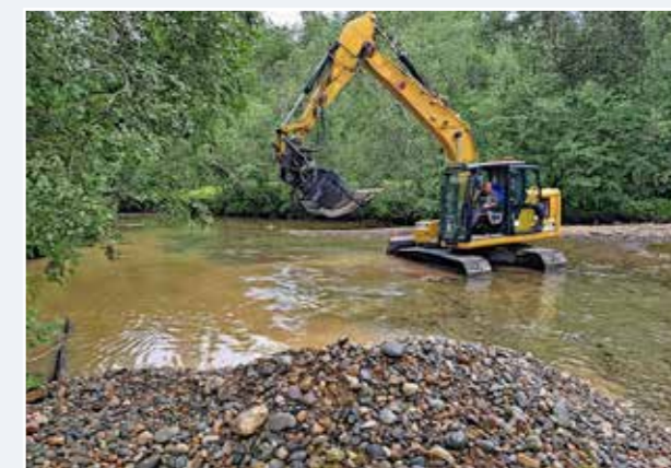
Utstyret for utsolding av finstoff var for svakt, så det ble tilført mer gytegrus enkelte steder. Etter støtte fra Reddvillaksen kunne forvaltningslaget kjøpe grus av svært god kvalitet. Bildene viser utleggingen nedstrøms Høln.
