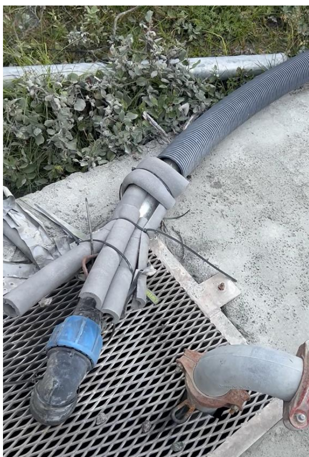
Bilde 3: Slamvannet ledes ned i bekkeinntaket (t.v. plastrør med isolasjon, t.h. stålrør uten isolasjon).
